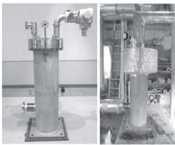
ポット型キャンドモーターポンプ。 右の画像上部には保冷材を巻いている
