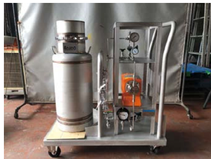
【非常用ポンプ注入式付臭装置】
